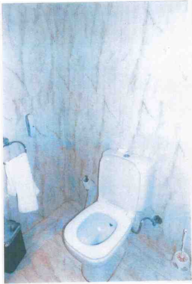
Obr. 35 Toaleta, umístěna napravo od umývacího prostoru, zdroj [13]
