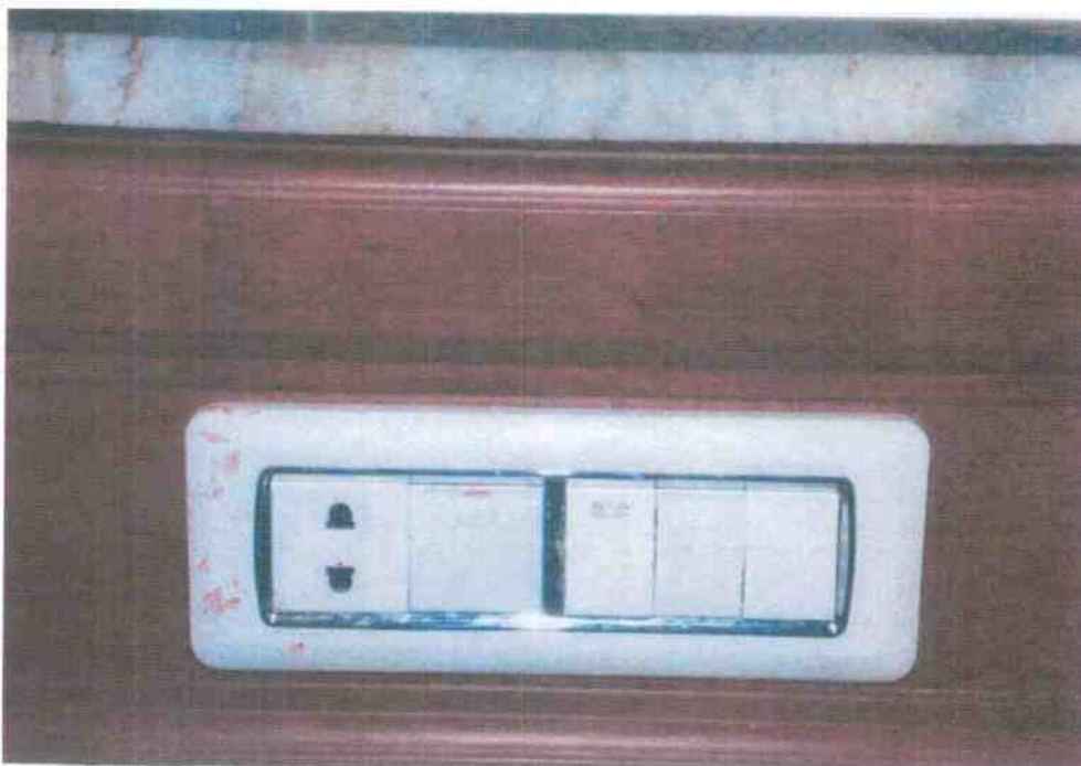
Obr. 23 Detail rámečku integrovaného spínače světel a zásuvky pokoje 6343, zdroj [13]
